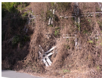
写真1 アンカー損傷状況
